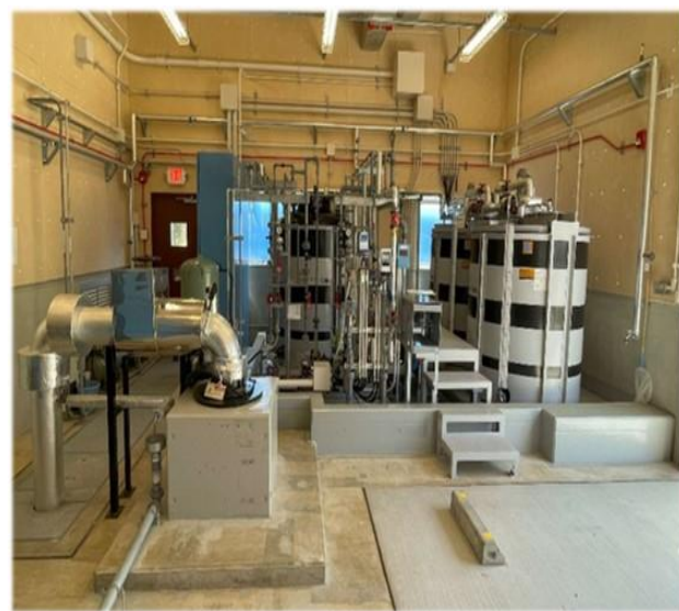
図 2 次亜塩素酸とフッ素貯蔵タンク
